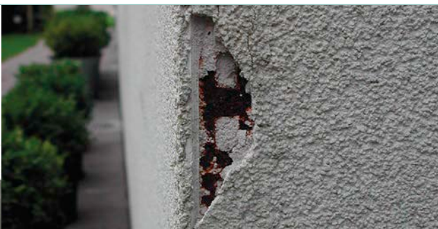
Corrosie van een hoekprofiel in gegalvaniseerd staal.
