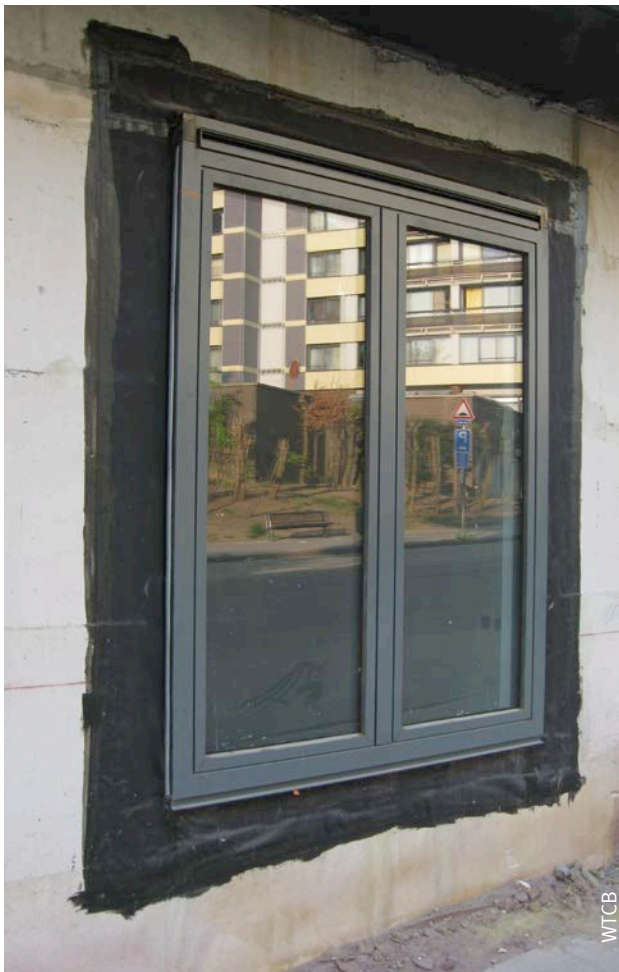
Afb. 56 Luchtscherm tussen het schrijnwerk en de muur.
