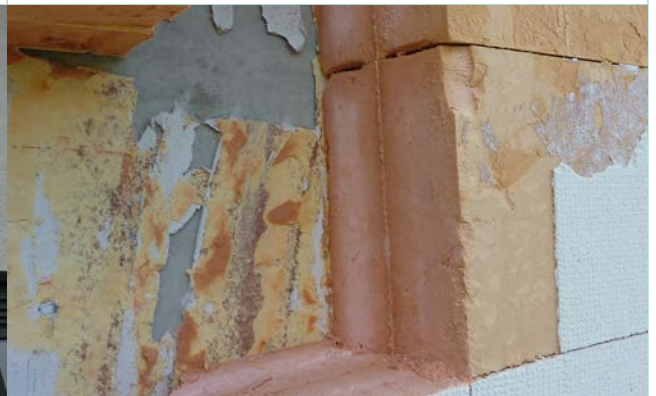
Aftekening van de voegen tussen de isolatieplaten aan het oppervlak van het ETICS, wat wijst op de dimensionale onstabiliteit van de isolatie.
