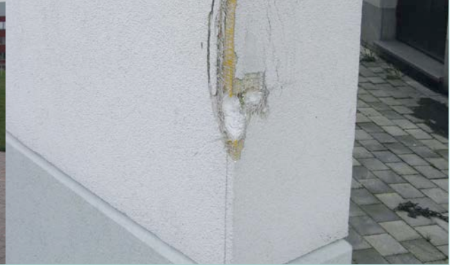
Mechanische beschadiging van een ETICS in een toegangszone voor vrachtwagens.
