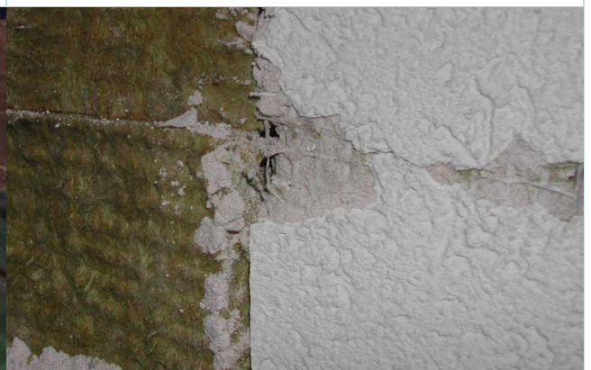
Niveaueverschil tussen de isolatieplaten en beperkte weerstand van de bepleistering waardoor er scheuren in ontstaan in de bepleistering ter hoogte van de naden tussen de platen.
