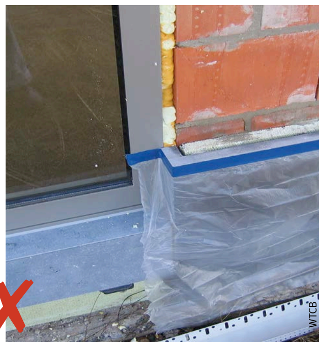
B. Niet EPB-conform
