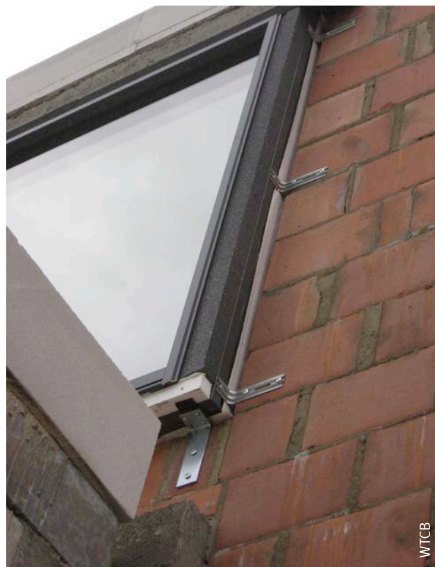
Afb. 55 Plaatsing van het vaste deel van het raamkader in het vlak van de gevelisolatie (excentrische plaatsing of plaatsing in opbouw).
