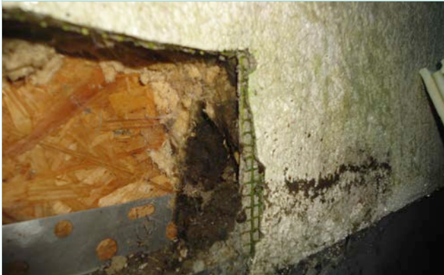
Het rotten van de houtvezelisolatie vastgesteld tijdens een sondering ter hoogte van een scheur.
