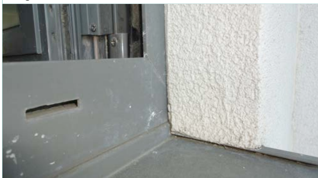
Waterinfiltratie binnenin het gebouw ten gevolge van een niet-waterdichte aansluiting tussen het ETICS en het schrijnwerk.
