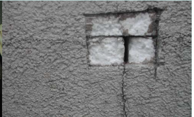
Niet-aaneensluitende isolatieplaten waardoor er een scheur ontstaat in de bepleistering.
