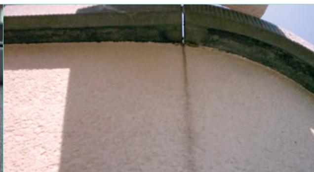
Druipsporen en vervuiling vanwege de aantasting van de voegmortel.
