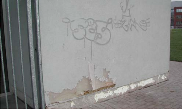
Ongeschikte keuze van een ETICS in een publieke zone onderhevig aan vandalisme
