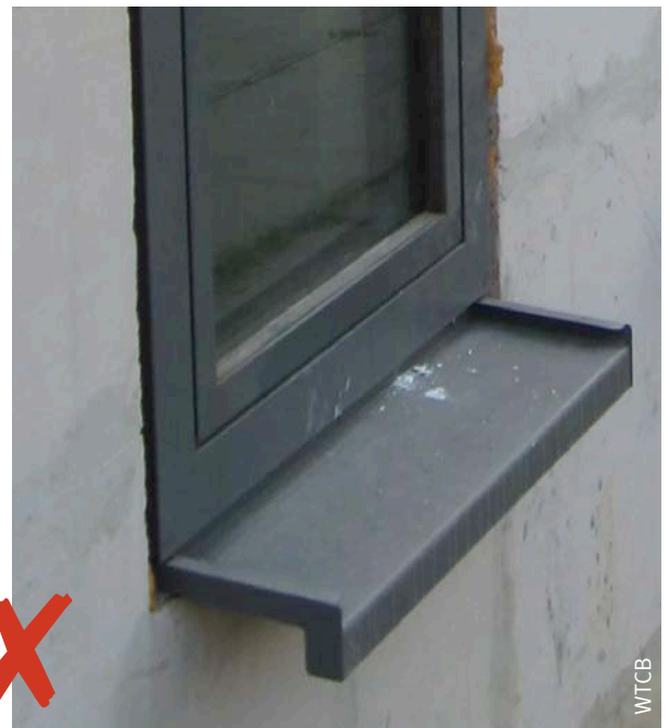
B. Niet EPB-conform
