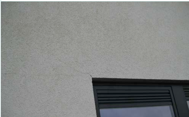
Scheurvorming in de bepleistering in de hoeken van de dagopening doordat de isolatieplaten niet uit één stuk bestaan en/of er geen bijkomend wapeningsweefsel aanwezig is.
