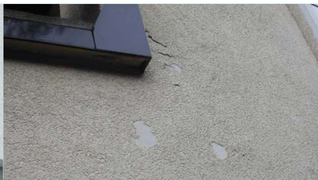
Het falen van de detaillering ter hoogte van de dorpel wat leidt tot waterinfiltraties in de bepleistering, blaasvorming en onthechtingen.
