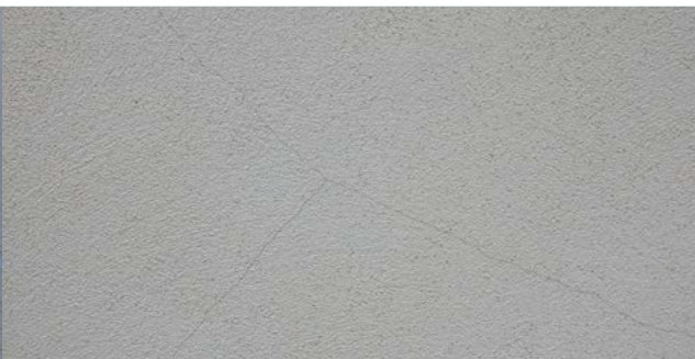
Scheurvorming in het minerale pleister (krimp) door de bindings- en de verhardingsvoorwaarden en de eigenschappen van het pleister.
