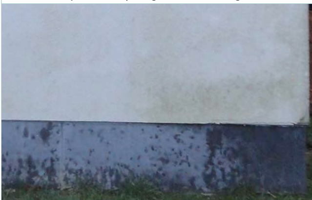
ETICS (houtvezelisolatie) op houtskelet met draagplaten voor het ETICS. Gevel die zeer sterk blootgesteld wordt aan slechte weersomstandigheden zonder specifieke beschermingsmaatregelen (bv. afwezigheid van de dakoversteek) en het verschijnen van vervuilingen.
