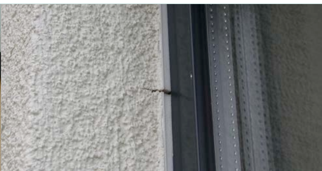
Scheurvorming in de bepleistering ter hoogte van de aansluiting tussen de profielen (de ontwikkeling is afhankelijk van de eigenschappen van de bepleistering en van de isolatie).
