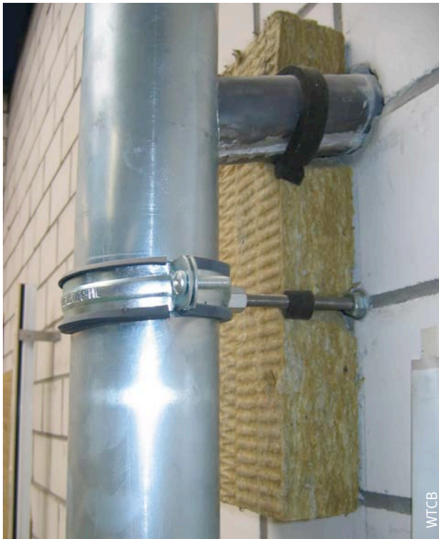
Afb. 111 Plaatsing van een zwelband (rugvulling) aan de aansluiting tussen de isolatieplaat en de doorboring van het ETICS.
