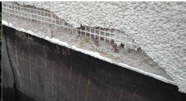
Scheurvorming en onthechting die te wijten zijn aan het te korte wapeningsweefsel dat niet verbonden is aan het startprofiel.
