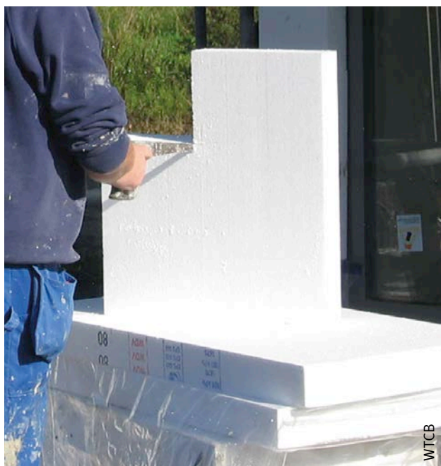
Afb. 107 Aangepast versnijding vóór de plaatsing van de plaat in de hoek van een dagopening.
