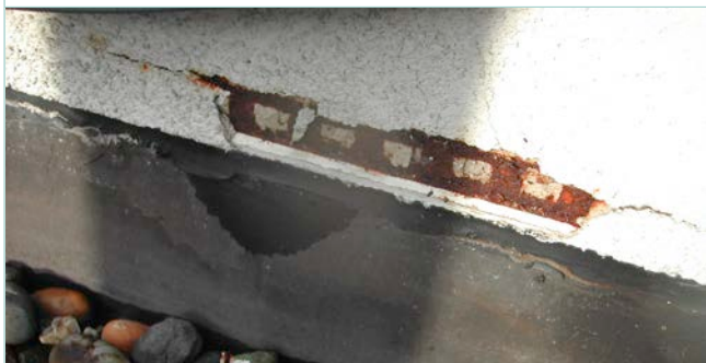
Corrosie van een startprofiel (ongeschikt vanwege de afwezigheid van een druiplijst) in gegalvaniseerd staal.
